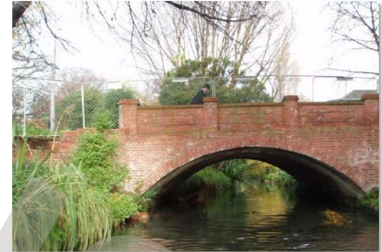
Collasso del parapetto – terremoto 2011 Nuova Zelanda
