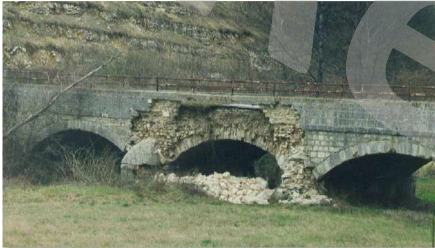
Collasso del timpano – terremoto 1977 Umbria e Marche
