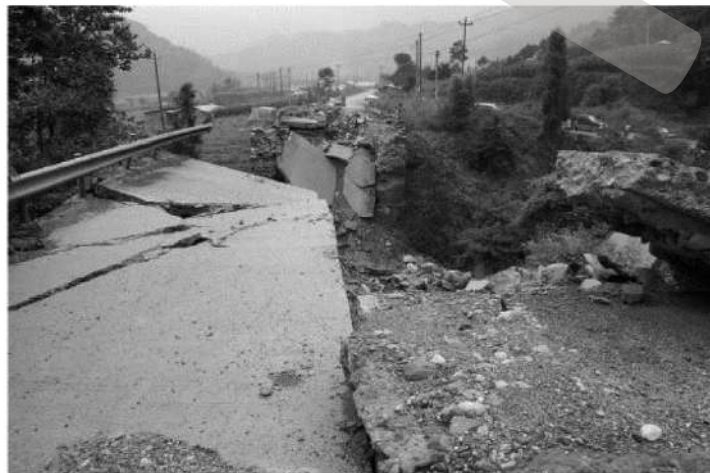
Collasso del ponte Yingchun (terremoto Wenchuan 2008)
