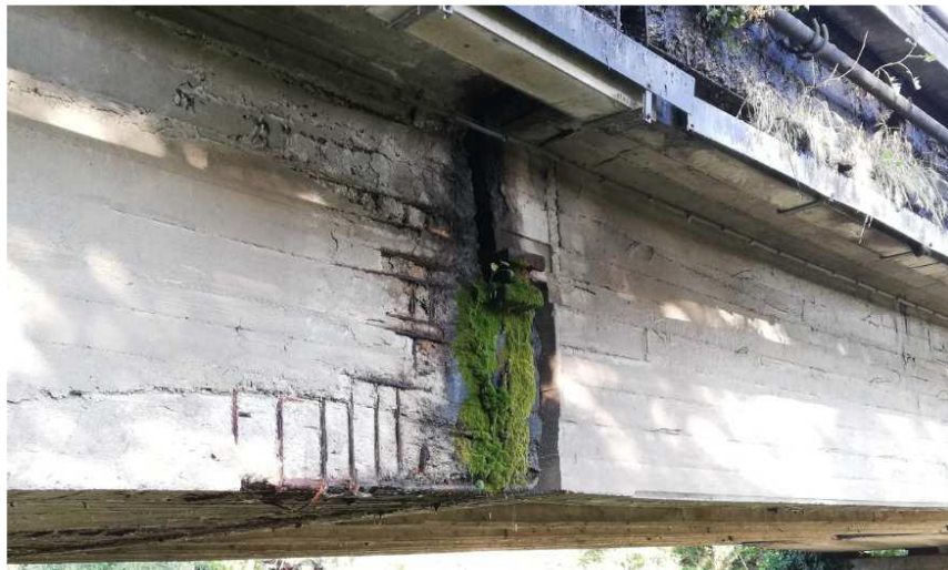
problemi di degrado che incidono sulla durabilità dei ponti
