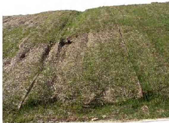
Figura 7-8 – Esempio di danneggiamento dovuto al dilavamento del rilevato di appoggio (MIT, 2020).
