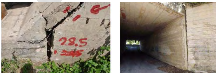
Figura 7-11 – Esempi di danneggiamento dovuti a movimenti di fondazione (MIT, 2020).
