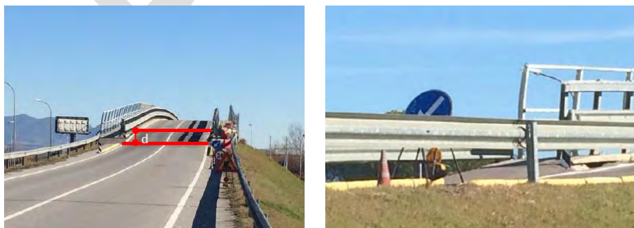
Figura 7-9 – Esempi di danneggiamenti dovuti al dissesto del rilevato di appoggio – Deformazioni (MIT, 2020).
