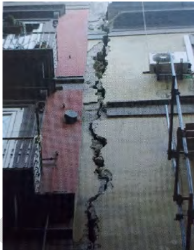
Figura 6-4 – Tipologie di danni strutturali per edifici in c.a. in seguito all'azione delle acque: Napoli – cedimenti subiti da un edificio a seguito di un nubifragio (Augenti, 2009).
