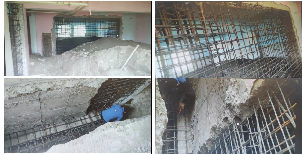
Fig. 6 – Foto di archivio fornite dall'amministrazione scolastica con illustrazioni delle fasi di intervento di realizzazione dei setti in c.a. posizionati all'interno della maglia strutturale al posto della tramezzatura (a,b), scavo in fondazione per il consolidamento delle stesse (c), dettaglio sulla connessione del setto alla maglia struttura pre-esistente (d).
