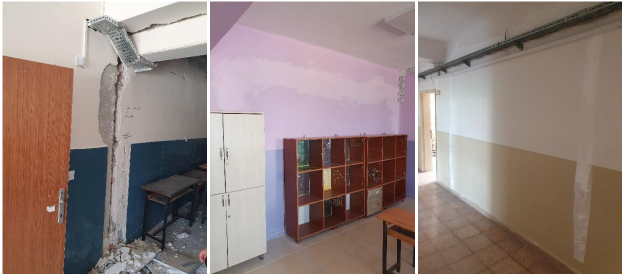
Fig. 8 – Evidenza dei danni dovuto al martellamento delle diverse unità strutturali contigue (a), e quelli nella zona di interfaccia tra il telaio originario in c.a. ed il setto adottato come sistema di rinforzo (b, c)
