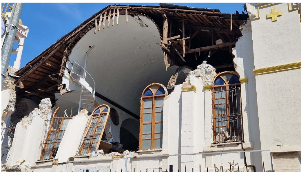
Fig. 11 – Crollo della facciata di una chiesa in muratura con copertura lignea.
