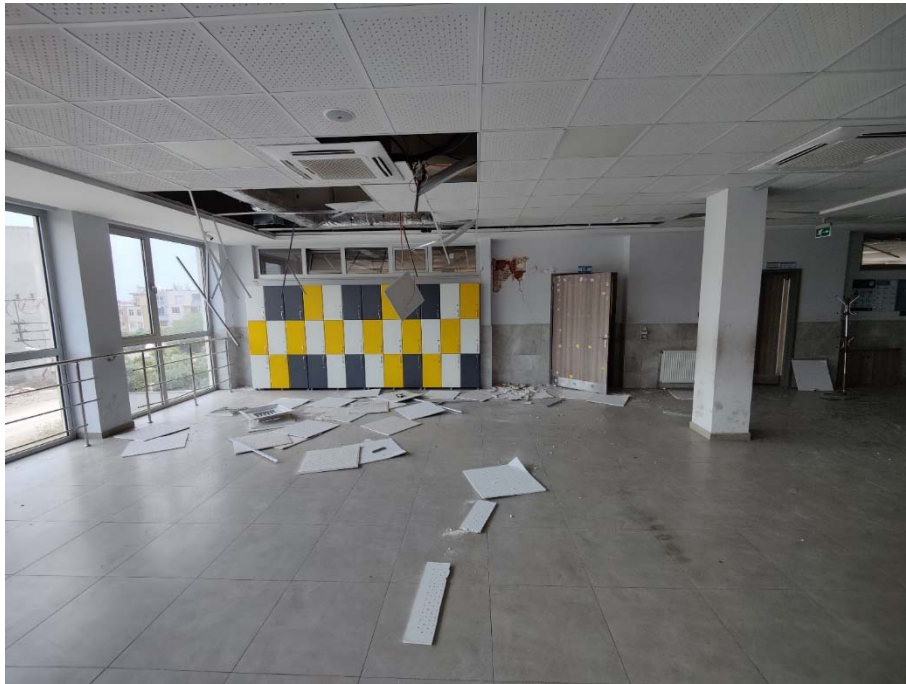
Fig. 7 – Vista frontale dell’edificio e distacco dei pannelli della controsoffittatura.
