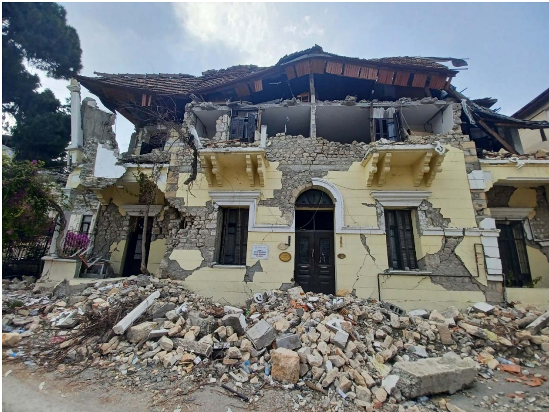
Fig. 9 - Stato di danno di edificio in muratura in pietra nel centro storico di Antiochia: collasso della copertura, meccanismi di crisi fuori piano e nel piano delle pareti. Peculiare è la sopravvivenza delle mensole dei balconi.
