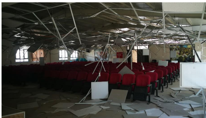
Fig. 4 Aula magna in piano sopraelevato. Danneggiamento diffuso del controsoffitto
