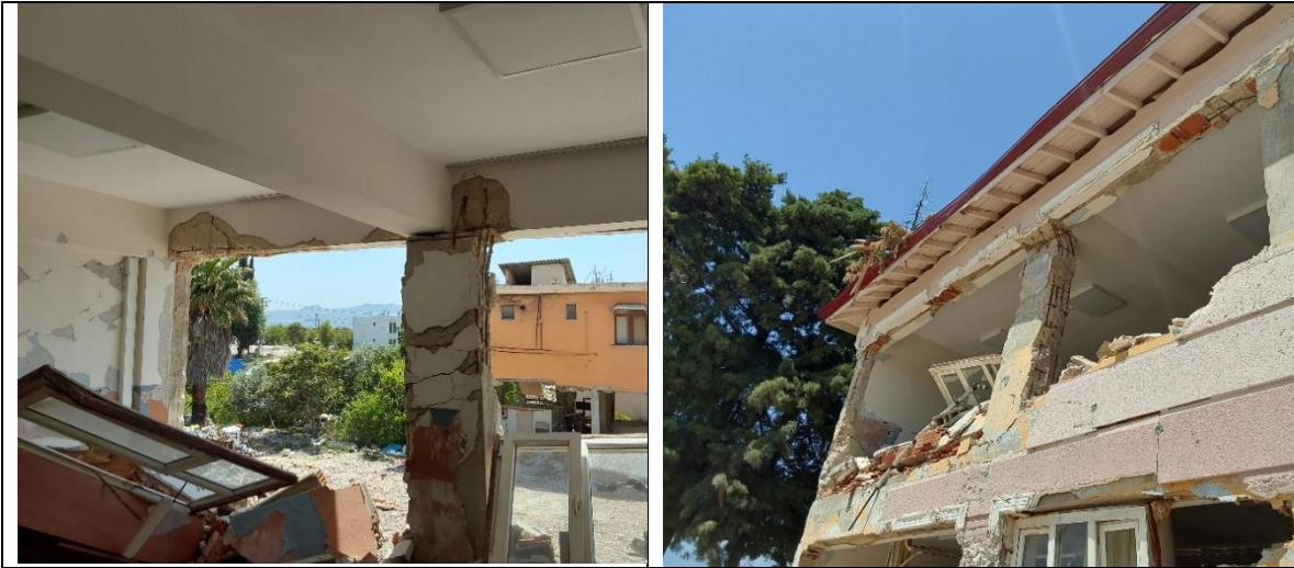
Fig. 6. Crisi di pilastro a taglio lungo il giunto d'interruzione del getto, per effetto di urto della struttura adiacente crollata: vista dall'esterno (sinistra) e dall'interno (destra). Scuola
