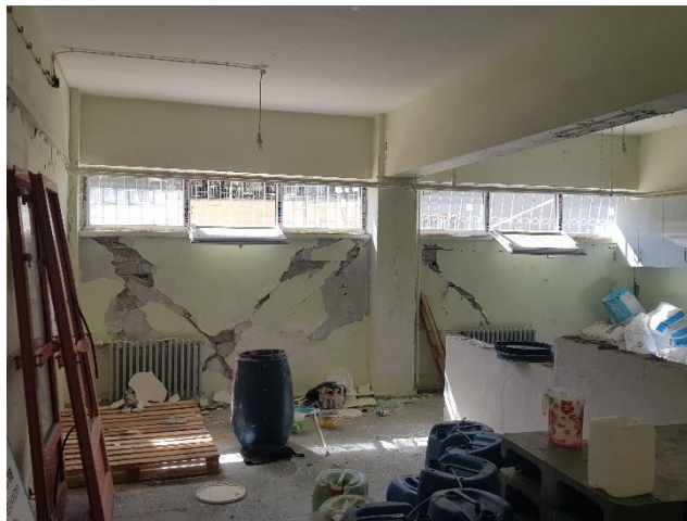
Fig. 7: Ampia fessurazione diagonale di tamponature e partizioni.
