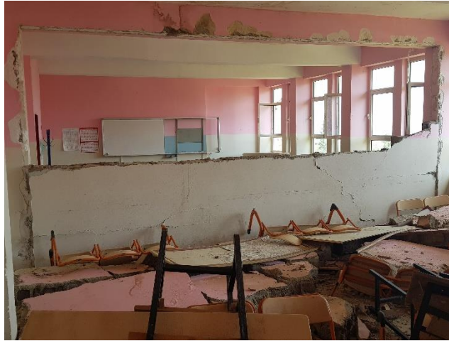
Fig. 8: ribaltamento fuori piano di tamponature e partizioni.
