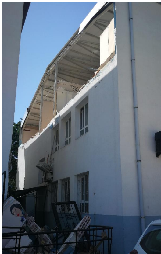
Fig. 3 Sopraelevazione in struttura metallica e copertura a travi reticolari, non adeguatamente collegata ai tamponamenti perimetrali
