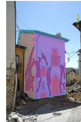
SEZIONE 4 - Danni ad ELEMENTI STRUTTURALI e provvedimenti di pronto intervento (P.I.) eseguiti
