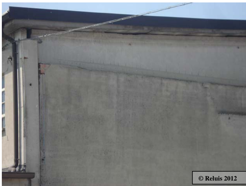
Figura 13 – Perdita di verticalità di un pilastro con conseguente riduzione dell'appoggio della trave principale
