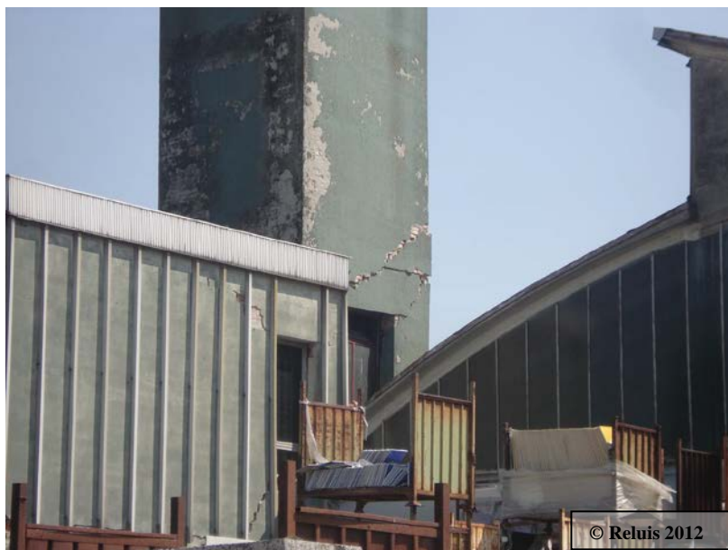
Figura 14 – Danneggiamento edificio “a torre” in muratura
