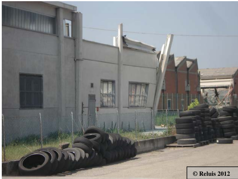
Figura 9 – Collasso pannelli di tamponatura orizzontali e copertura
