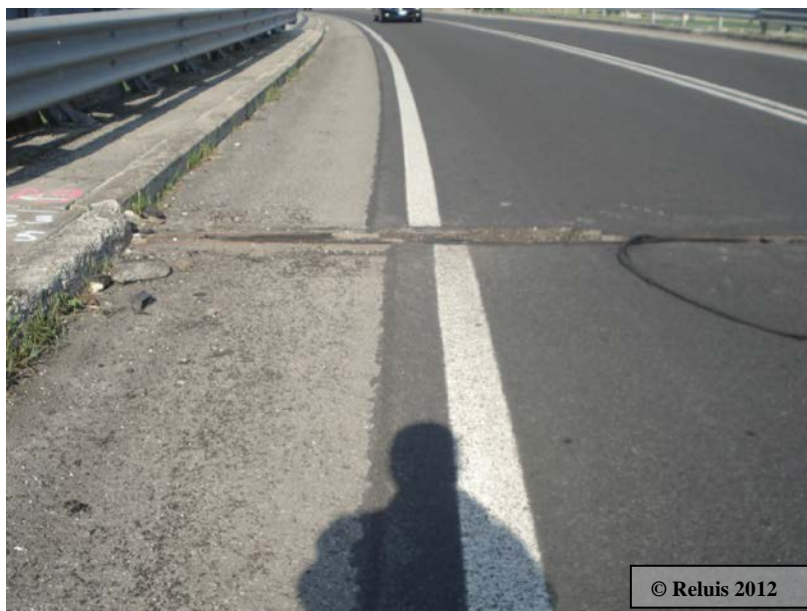
Figura 23 – Scorrimento relativo permanente tra le travate di un ponte stradale
