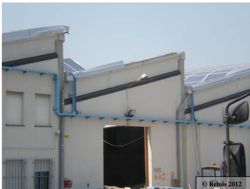
Figura 25 – Collasso copertura a shed
