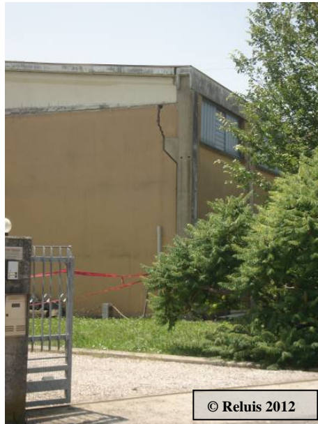
Figura 2 – Fessurazione del pannello di tamponatura in laterizio in seguito alla perdita di verticalità del pilastro
