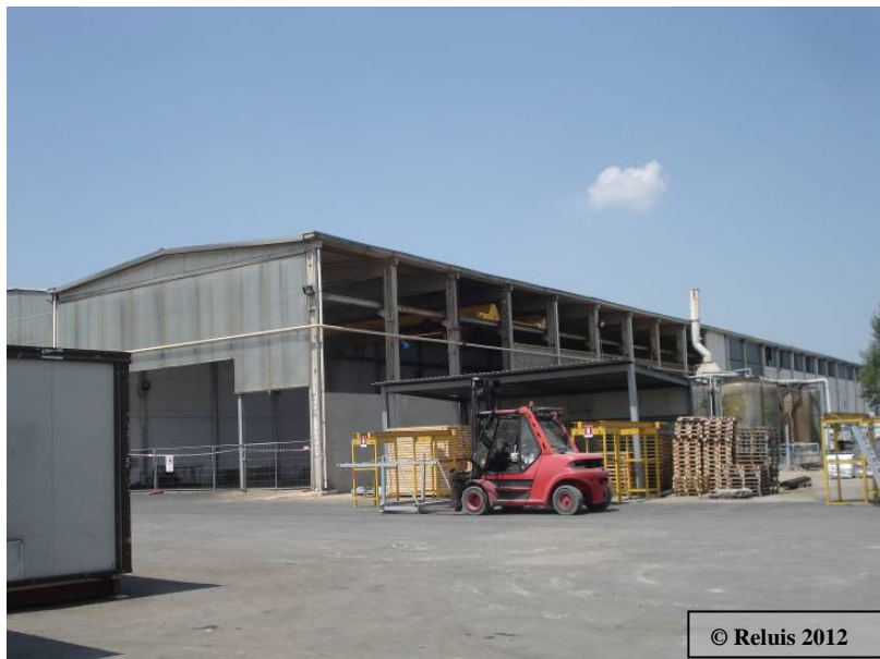
Figura 4 – Crollo pannelli di tamponatura orizzontali
