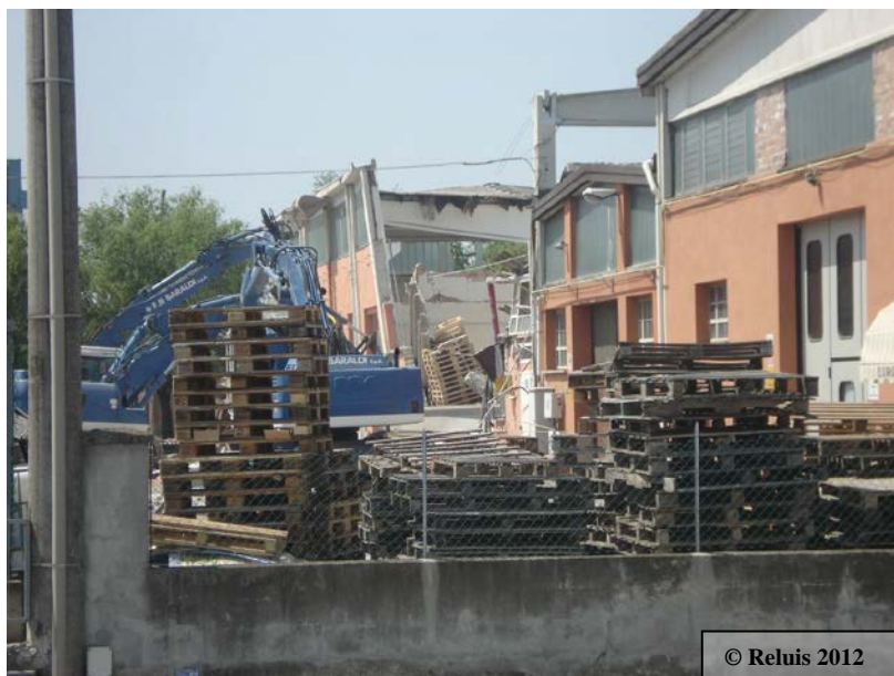
Figura 8 – Demolizione di una struttura prefabbricata conseguente al collasso parziale della stessa
