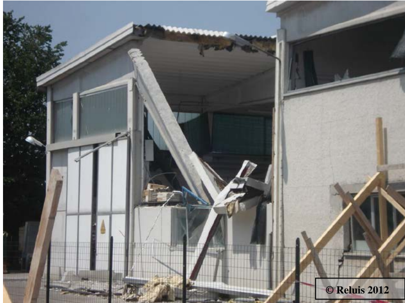
Figura 7 – Collasso trave principale nella sezione di mezzeria a causa della perdita di appoggio
