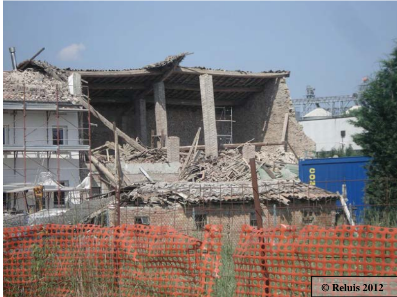
Figura 16 – Collasso totale di una struttura in muratura
