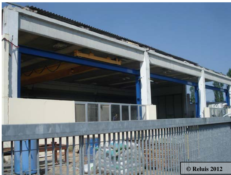
Figura 18 – Collasso pannelli di tamponatura orizzontali
