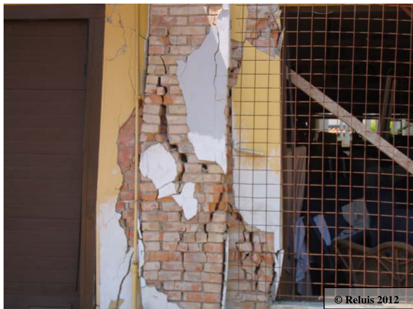
Figura 1 – Crisi di pannelli di maschio per azioni in piano (vista globale e dettaglio)
