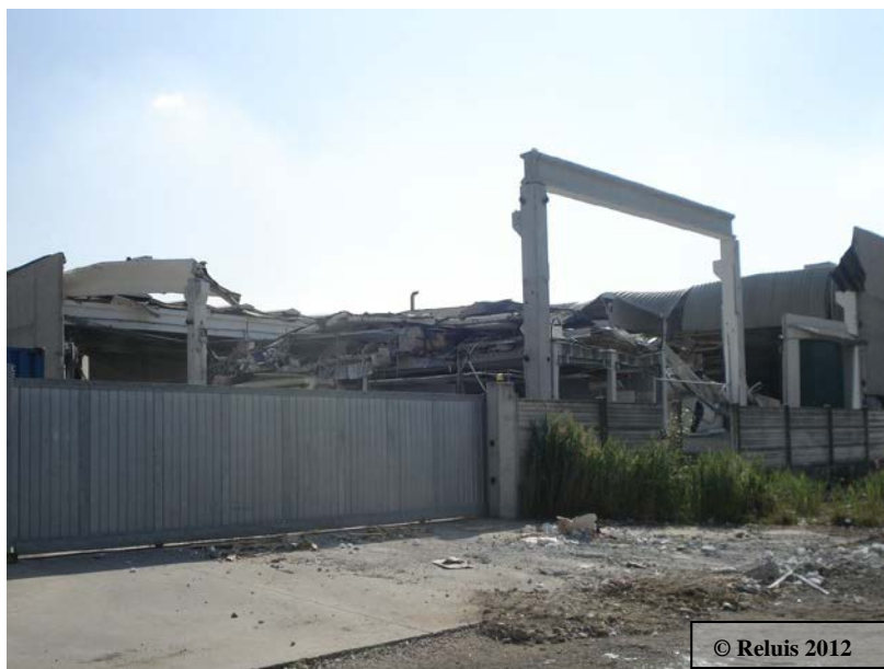
Figura 10 – Collasso struttura prefabbricata monopiano
