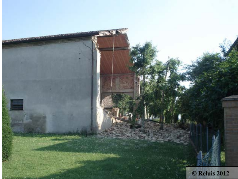
Figura 22 – Ribaltamento parete muraria per meccanismo fuori dal piano
