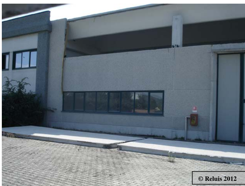
Figura 15 – Collasso pannelli di tamponatura orizzontali
