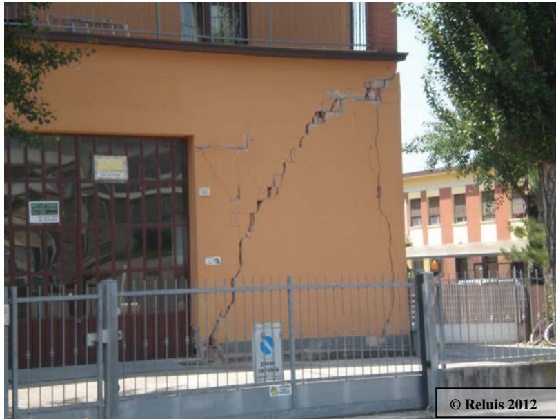
Figura 24 – Crisi di un pannello murario per azioni in piano
