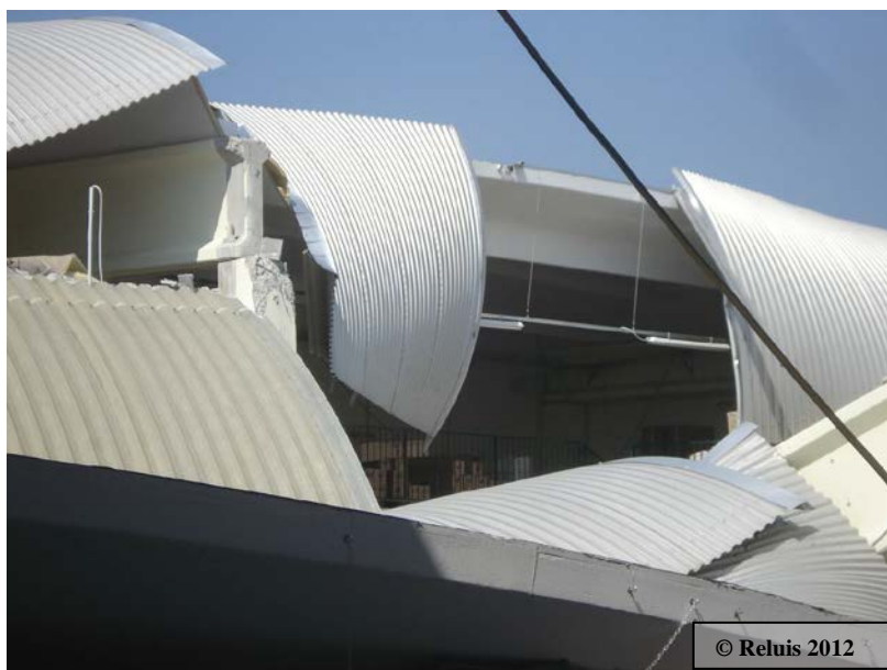
Figura 19 – Collasso connessione spinottata trave pilastro con conseguente crollo della copertura
