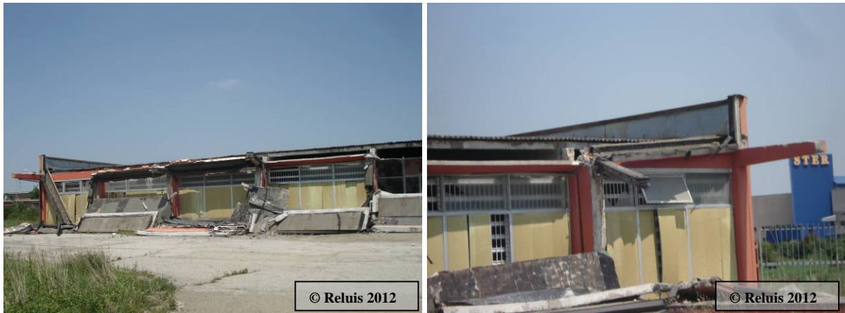
Figura 3 – Collasso pensilina in c.a. a sbalzo da struttura monopiano prefabbricata
