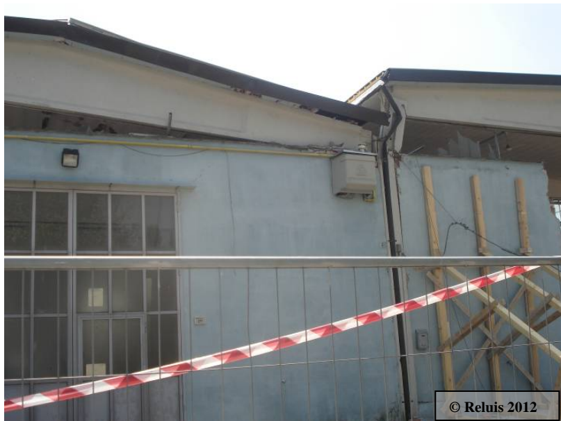
Figura 6 – Perdita di appoggio della trave principale a causa della crisi a taglio della parte di pilastro libera da tamponatura
