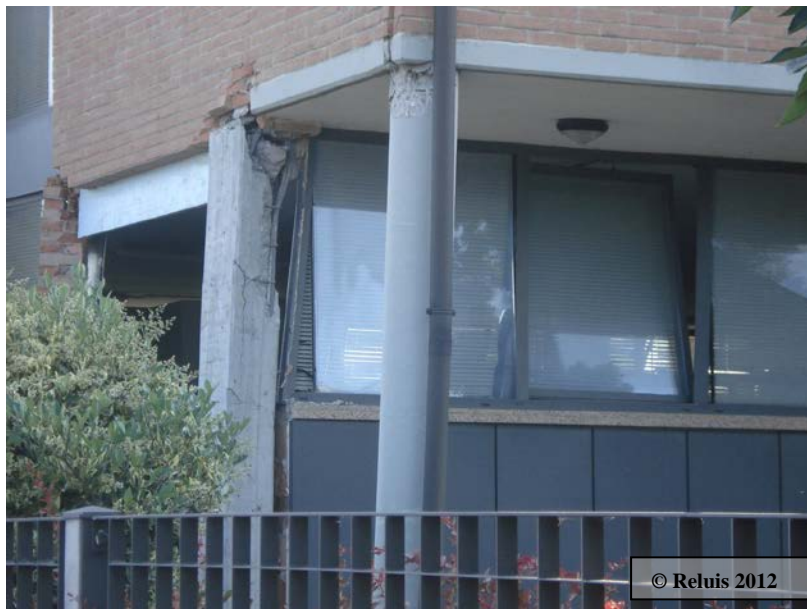
Figura 11 – Crisi di pilastri con formazione di cerniere plastiche a causa dell'incipiente meccanismo di piano sofficato al primo impalcato di una struttura in c.a.
