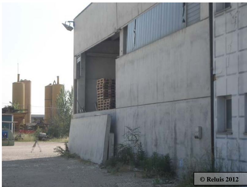
Figura 17 – Collasso pannelli di tamponatura orizzontali
