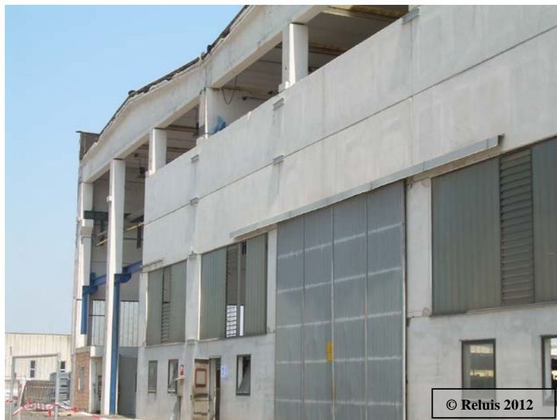
Figura 5 – Collasso pannelli di tamponatura orizzontali
