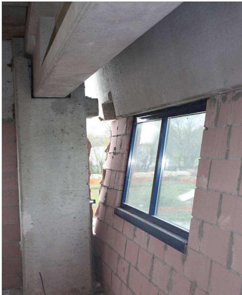
Figura 26 - Velette fuori piano in sommità dell'edificio nelle facciate orientate est-ovest vista dall'interno(foto dell'ing. F. Giordano).
