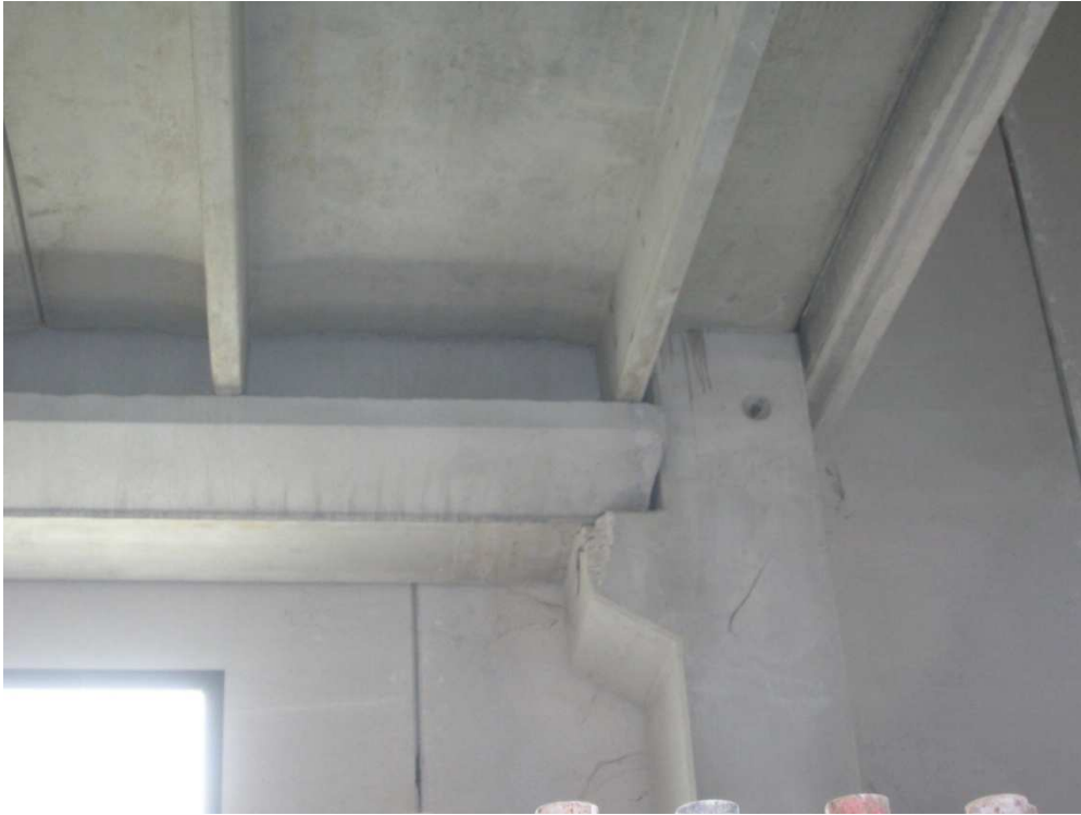
Figura 17 - Danneggiamento dalle selle di appoggio alla connessione trave/pilastro (foto dell'ing. A. Zambrano).
