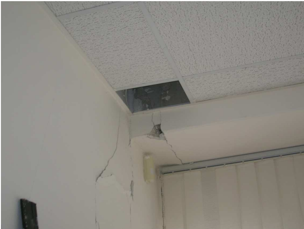
Figura 14 - Martellamento fra elementi strutturali all'edificio industriale adibito ad Uffici (foto dell'ing. A. Zambrano).
