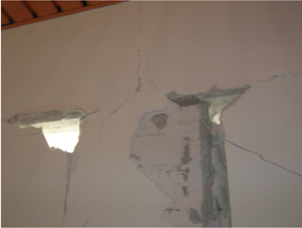
Figura 15 - Danneggiamento delle tramezzature nell'edificio industriale adibito ad Uffici (foto dell'ing. A. Zambrano).
