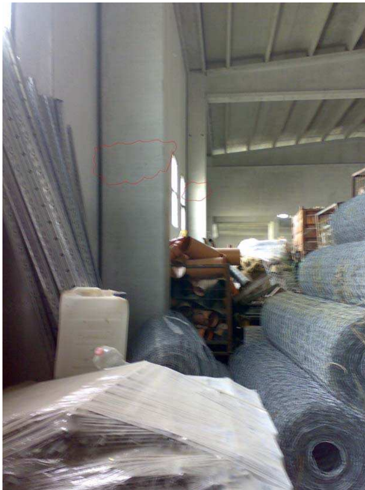
Figura 18 - Lesioni orizzontali nei pilastri del capannone industriale adibito a Deposito (foto dell'ing. R. Iafrate)
