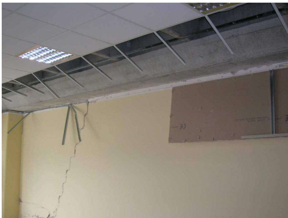
Figura 12 - Danno non strutturale all'edificio industriale adibito ad Uffici (foto dell'ing. A. Zambrano).
