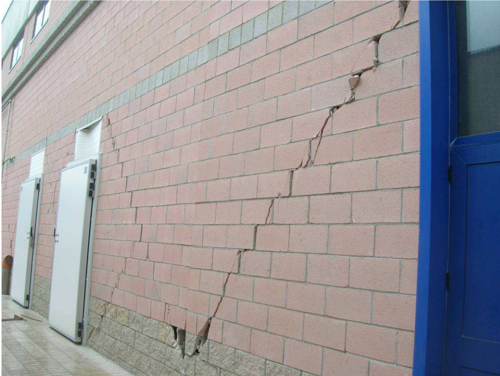
Figura 27 - Danno nelle tomagnature in corrispondenza delle porte delle celle frigorifere (foto dell'ing. A. Zambrano).
