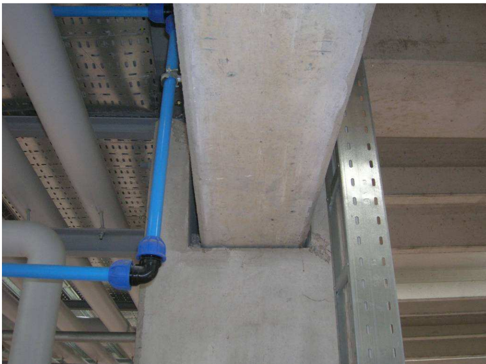
Figura 22 - Danneggiamento del nodo colonna-trave in corrispondenza del ritegno sismico in copertura (foto dell'ing. A. Zambrano).
