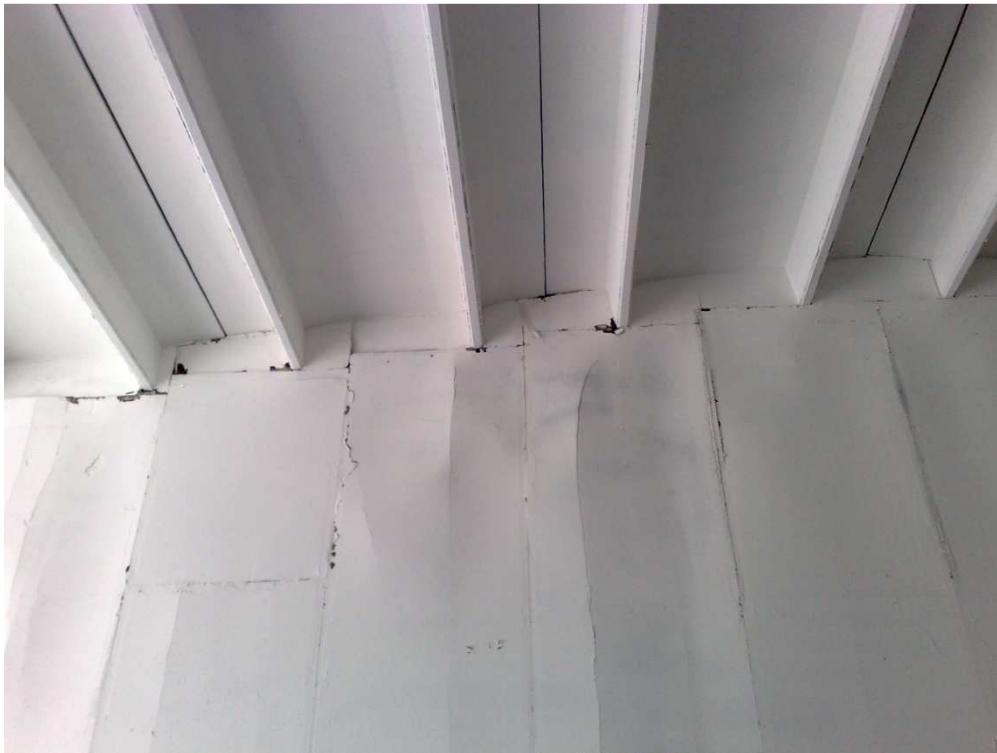
Figura 7 - Schiacciamento dei pannelli (Foto dell'Arch. A. Di Nunzio).
