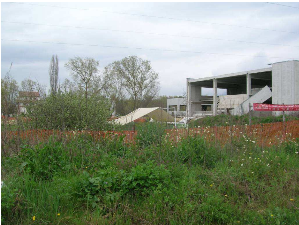
Figura 28 - Fuori piano delle tomagnature esterne dell'edificio prefabbricato in Monticchio (AQ) (foto dell'ing. A. Zambrano).
