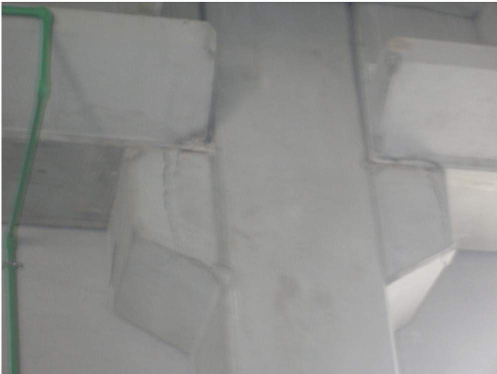
Figura 16 - Lesioni verticali alle selle di appoggio alla connessione trave/pilastro (foto dell'ing. A. Zambrano)
