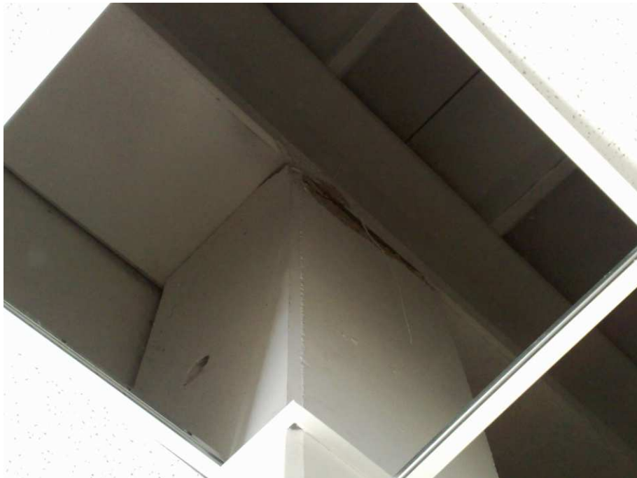
Figura 5 - Effetti di Martellamento fra capriata e pilastro centrale(Foto dell'Arch. A. Di Nunzio)
