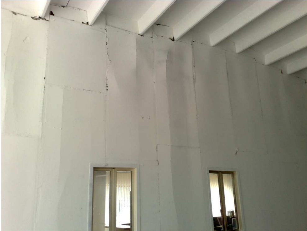
Figura 8 - Schiacciamento dei pannelli (Foto dell'Arch. A. Di Nunzio).
