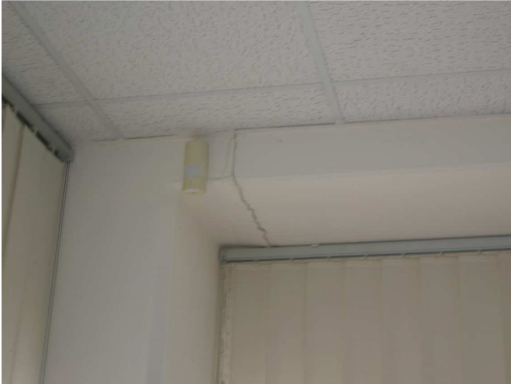
Figura 13 - Movimento fra elementi strutturali all'edificio industriale adibito ad Uffici (foto dell'ing. A. Zambrano).
