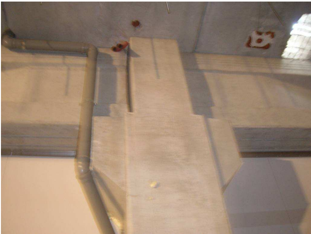
Figura 20 - Particolare del nodo trave-colonna del capannone industriale adibito alla produzione al piano terra (foto dell'ing. A. Zambrano).
