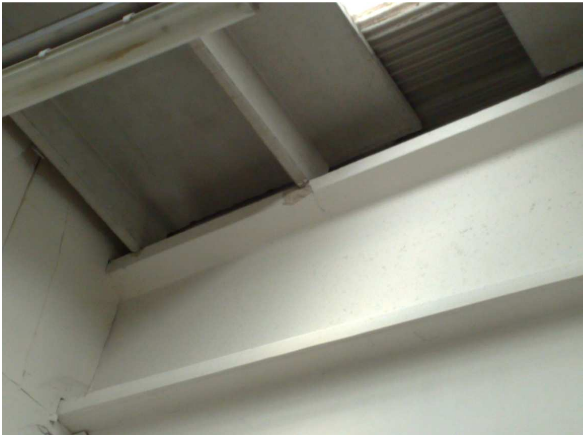
Figura 3 - Effetti di martellamento dei tegoli di copertura sulla trave (Foto dell'Arch. A. Di Nunzio).
