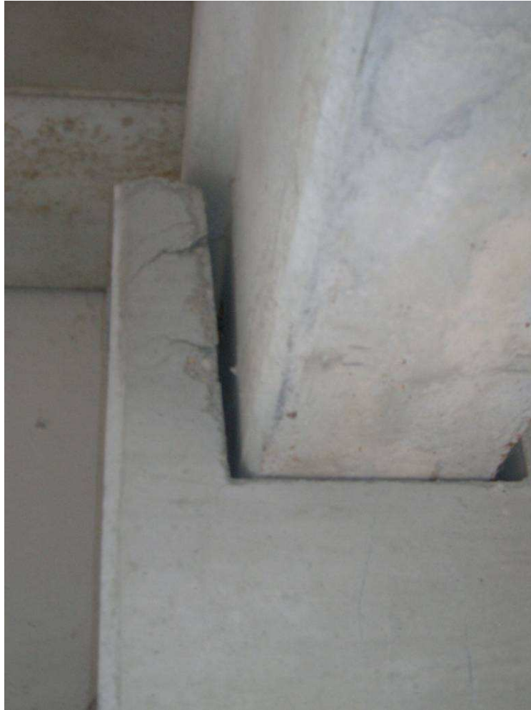
Figura 21 - Danneggiamento del nodo colonna-trave in corrispondenza del ritegno sismico in copertura (foto dell'ing. A. Zambrano).
