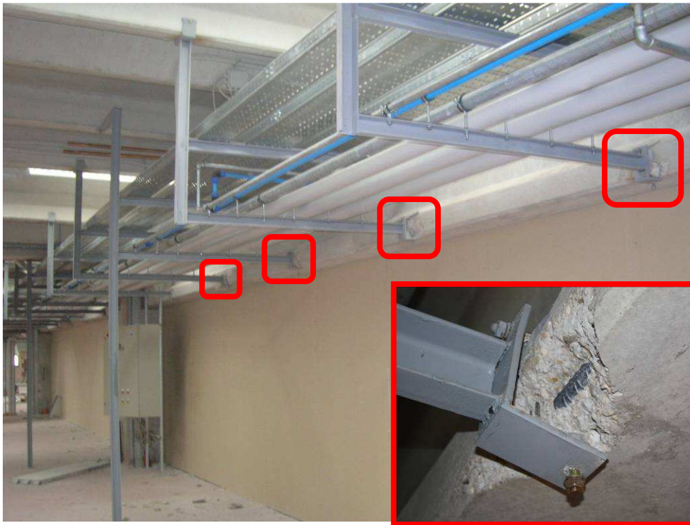
Figura 23 - Danneggiamento del copriferro delle travi in corrispondenza del collegamento con struttura in acciaio (foto dell'ing. A. Zambrano & F. Giordano).
