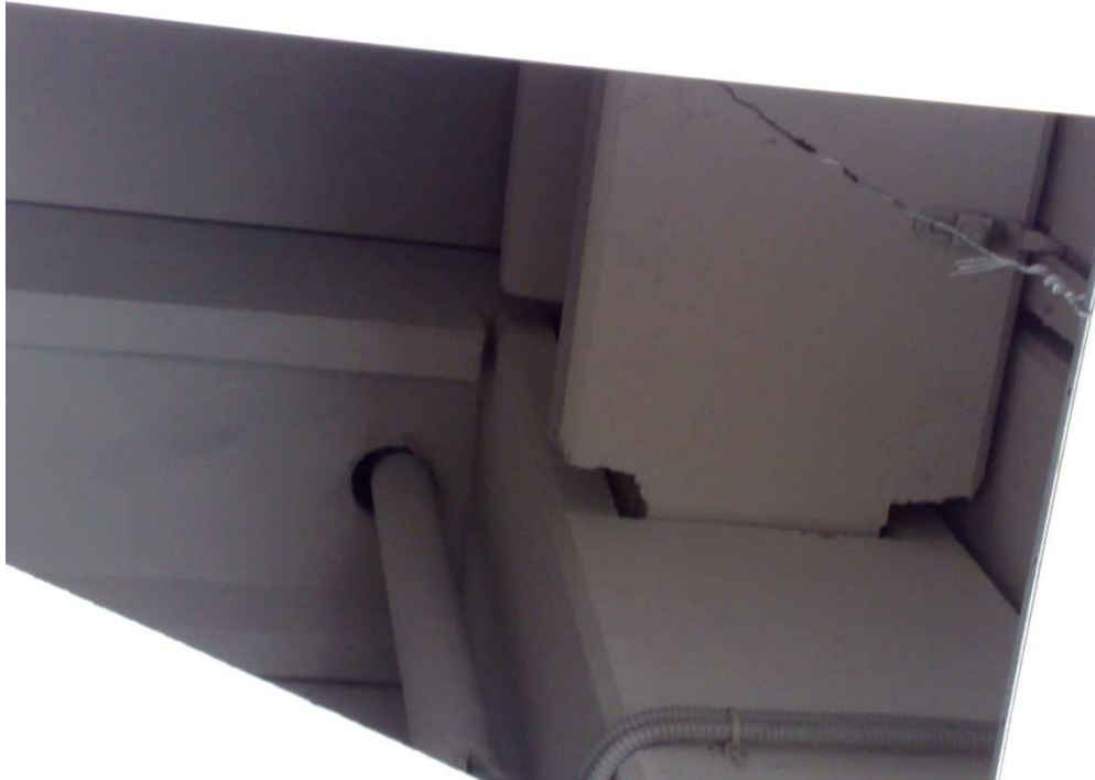
Figura 6 - Effetti di martellamento all'innesto a forcella fra pilastro di estremità e capriata. (Foto dell'Arch. A. Di Nunzio).
