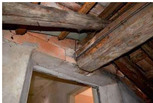
Figura 35: Appoggio trave di colmo sul lato nord
