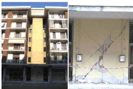
Figura 2.1 – Danno alla base di un vano scale di un edificio in C.A. in seguito al terremoto dell'Emilia del 2012. (da Maneges et al., 2012)
