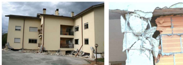
Figura 3.1 – Meccanismi di collasso legati ai tamponamenti: globale a) per formazione piano debole; locale, b) per formazione pilastro corto. (a) da Preti et al., 2012, b) da Maneges e Pampanin, 2004).
